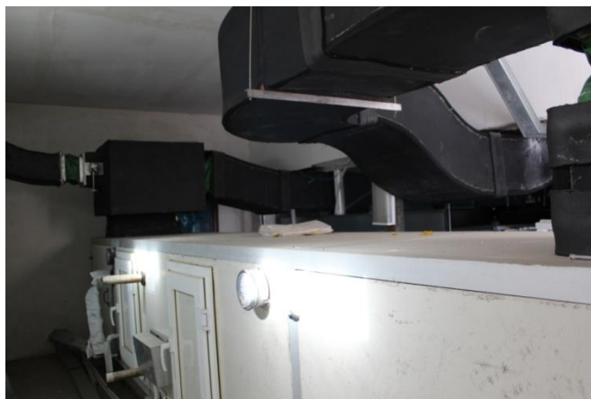
Рисунок 3 – Вентиляционная камера в пространстве «двойного потолка»
