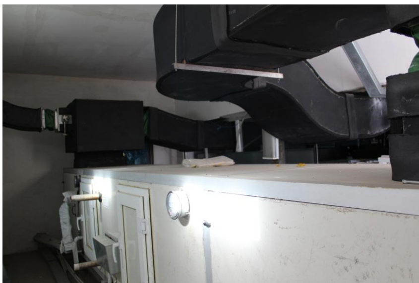
Рисунок 3 - Вентиляционная камера в пространстве «двойного потолка»
